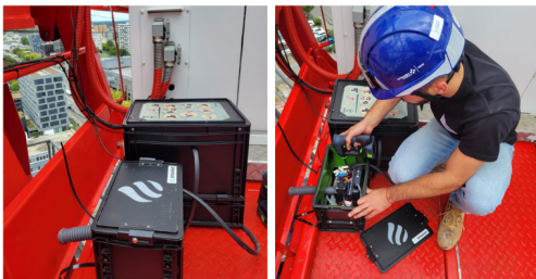
Installation d'un boîtier Etteliot S dans une grue
